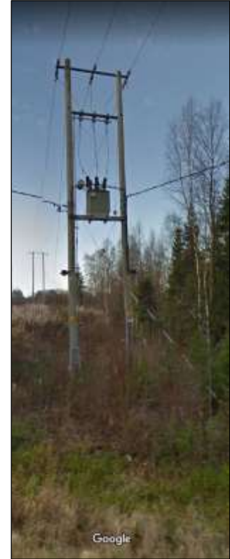
Kuva 5.2. Esimerkki maastotietokannassa esitetyistä muuntajista Korkeantiellä. Kuva: Google Maps, Street View
